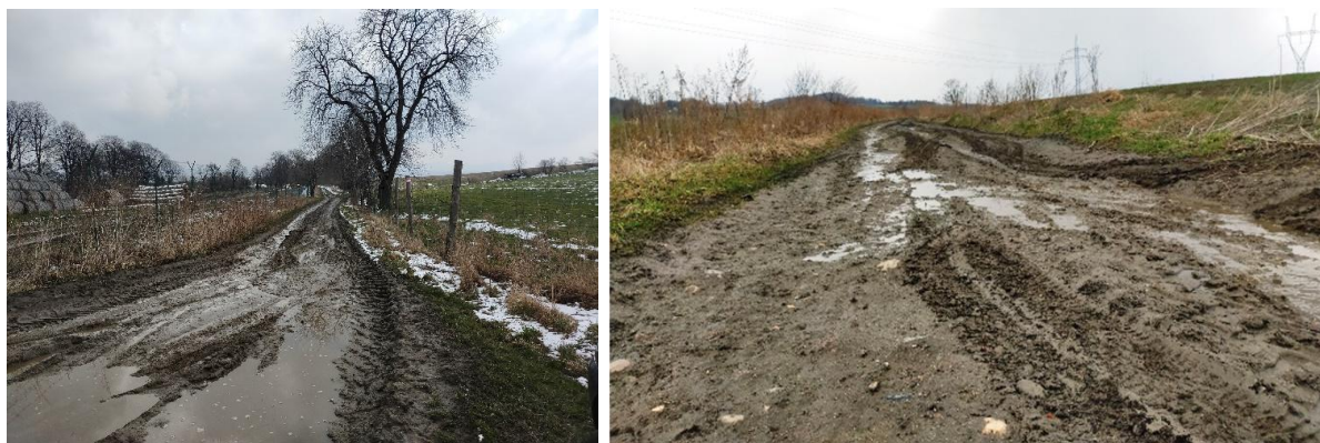
Ilustracja 23. Stan dróg wytypowanych do przebudowy na obiekcie Mokreszów (marzec 2021)
