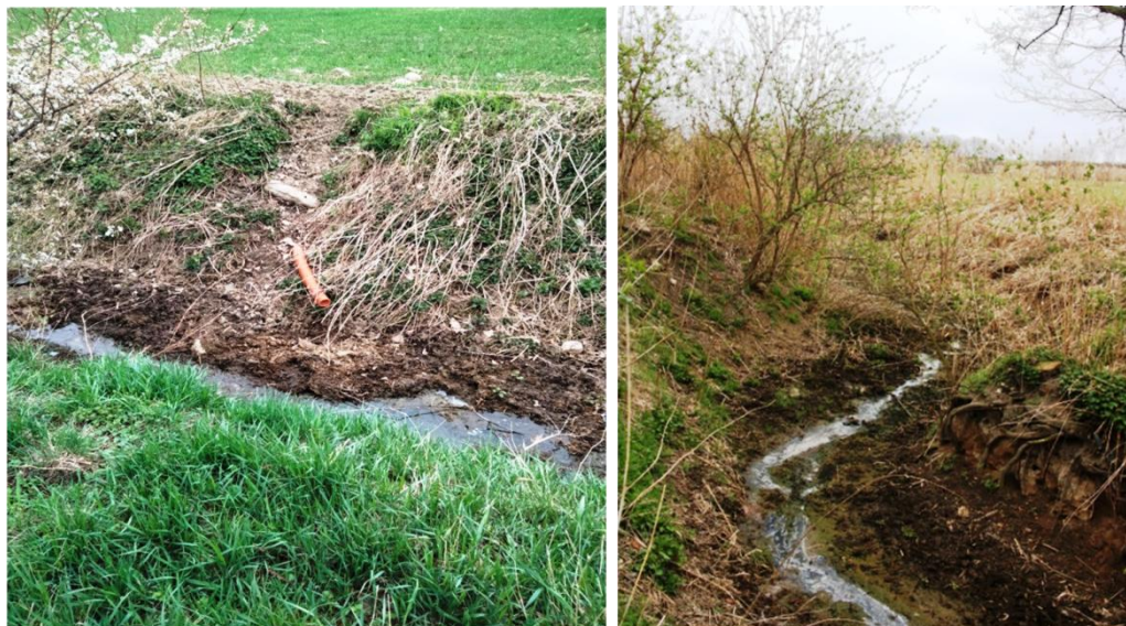
Ilustracja 65. Uszkodzony wylot drenarski oraz zdewastowany przez erozję odbiornik (rów)
