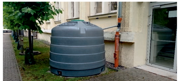
Fot. 3.3. Zbiorniki do gromadzenia wody opadowej: (A) tradycyjna beczka (fot. A. Kowalczyk), (B) beczka z dekoracyjną obudową, (C) zbiornik zewnętrzny przy budynku AGH w Krakowie (fot. M. Kopacz)
